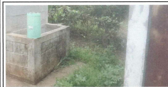
Foto 5: Mantenimiento y mejoramiento de lava manos
