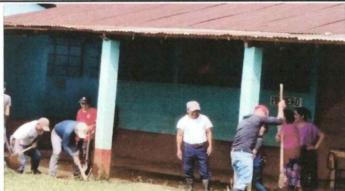
Foto 1: Las laminas se encuentran en muy mal estado y en épocas de lluvia infiltra agua dentro de las aulas.
